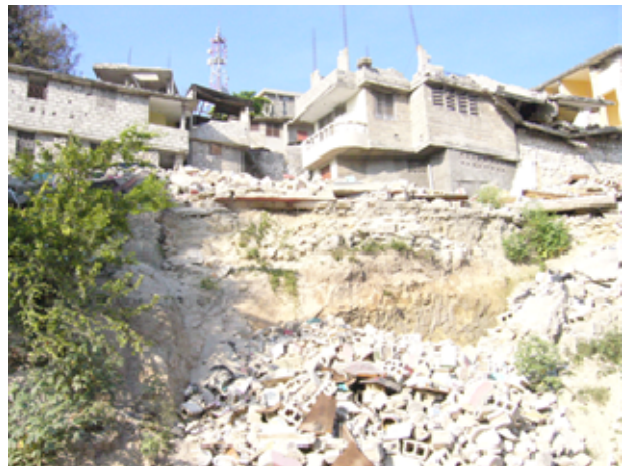
图 17 住宅区的斜面垮塌 2010 海地（CODE 提供）
