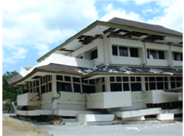
图6 1层楼层坍塌的大学的校舍 日惹
