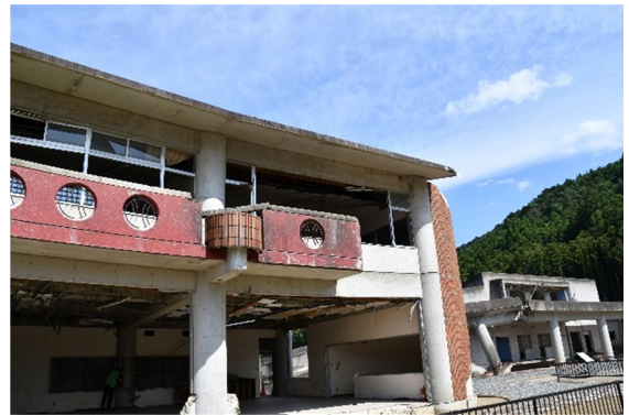
津波の被害が 2 階にも及び、屋根まで破壊している。津波のエネルギーとスピードは圧倒的なものだった。
