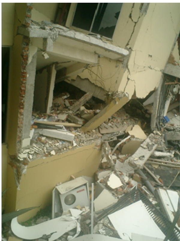
図14 近代建築の被害 2009 パダン、インドネシア
