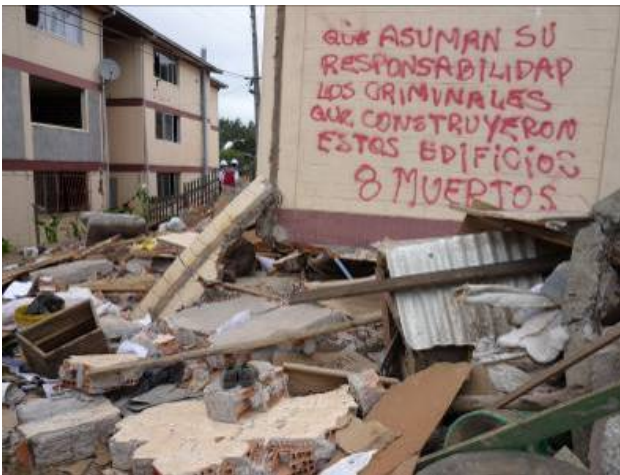
図25 2009年チリ地震による建物被害（1階の層崩壊）
