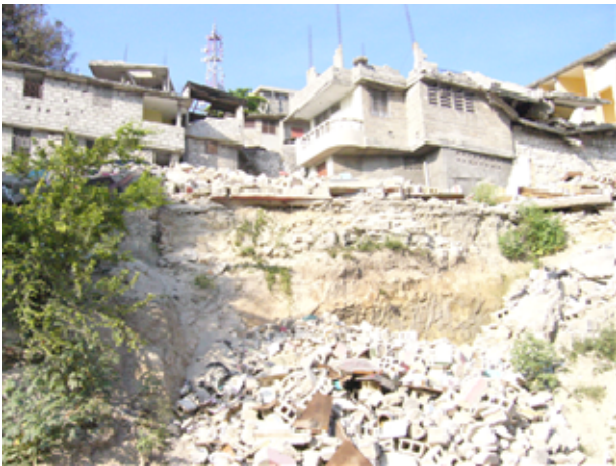
図17 住宅地の斜面崩壊 2010 ハイチ (CODE 提供)
