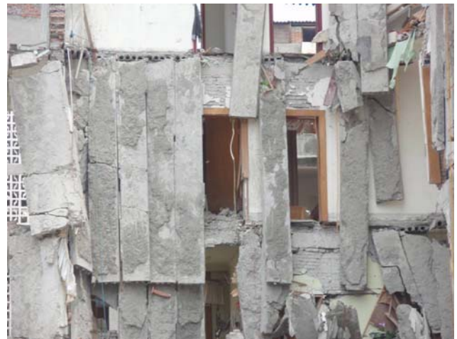
図22 2008年四川地震による建物被害 (2008年6月)
