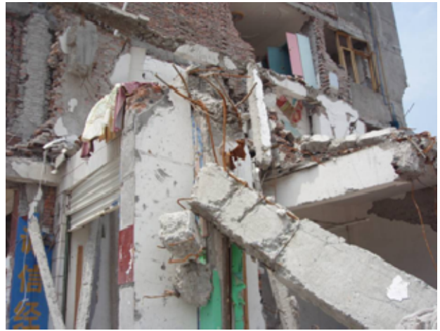
図13 中高層建築の被害 2008 都江堰、四川
