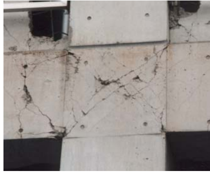
写真 2.10 : 1995 年兵庫県南部地震で梁曲げ降伏先行型骨組の柱梁接合部にせん断ひび割れ。
