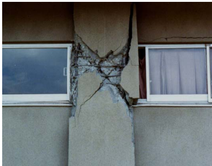
写真 2.6 : 1978 年宮城県沖地震における鉄道学園。鉄筋コンクリート造非構造壁が細い柱の変形
