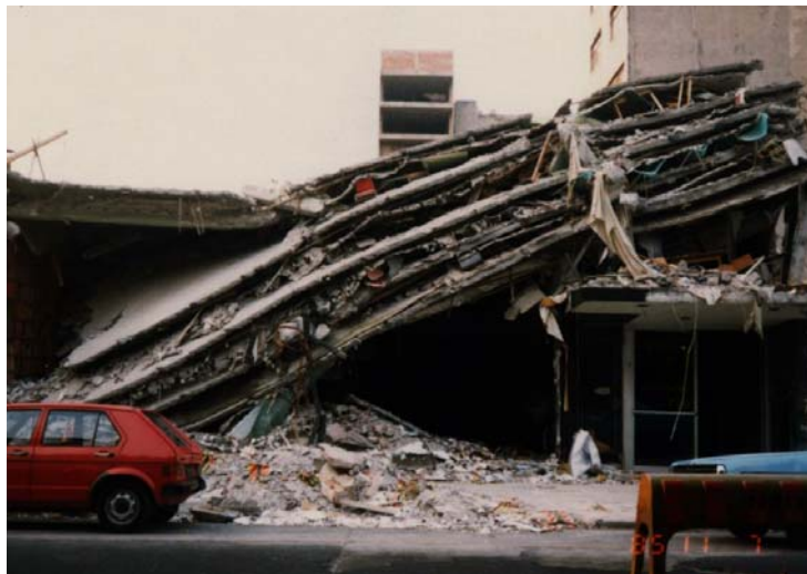
写真 1.6 : 1985 年メキシコ地震における学校建物の崩壊。多くの建物がこのようなパンケーキ状に崩壊した。
