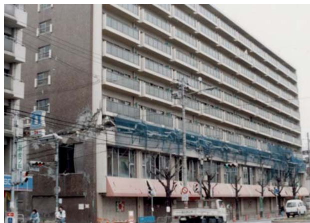
写真 1.1：1995 年兵庫県南部自身で層崩壊した共同住宅。
