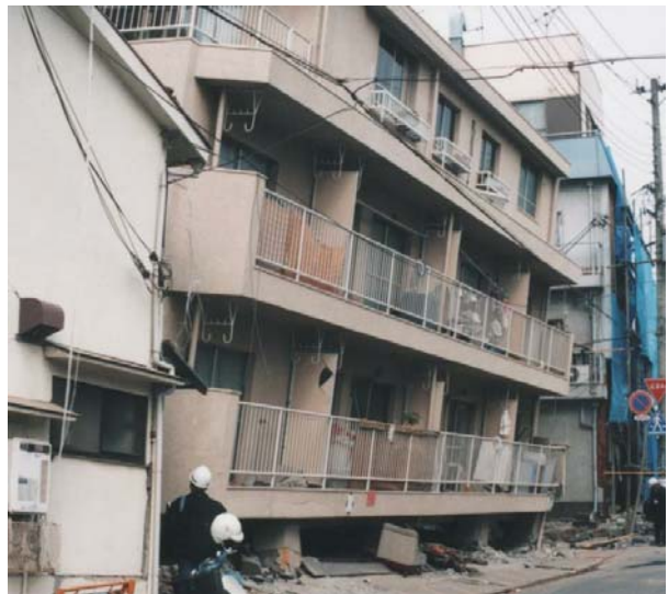
写真 1.3 : 1995 年兵庫県南部地震で1階が崩壊した六甲ビル
