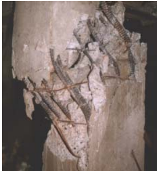
写真 2.3 : 1990 年 Luzon (フィリッピン) 地震でせん断補強筋が細く、間隔が粗いためにせん断破壊した柱。
