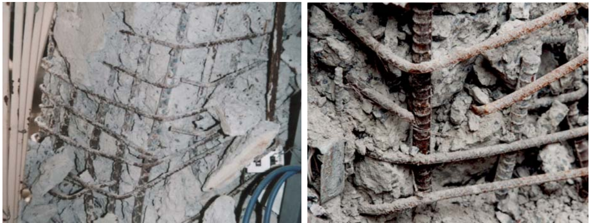
写真 2.5 : 1995 年兵庫県南部地震における柱のせん断破壊。(左)90 度折り曲げ部分が開いた例。(右)柱の角で横補強筋が破断した例。
