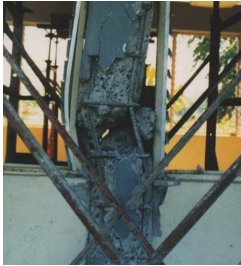
写真 2.4 : 柱のせん断破壊。1995 年 Mexico 地震の Lazaro Cardenas の学校建物。太径の横補強筋の間隔は柱幅程度に粗い。柱の主筋に沿ったコンクリートの剥落。
