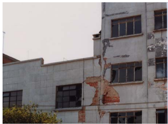
写真 1.6 : 1985 年メキシコ地震における隣接建物の衝突
