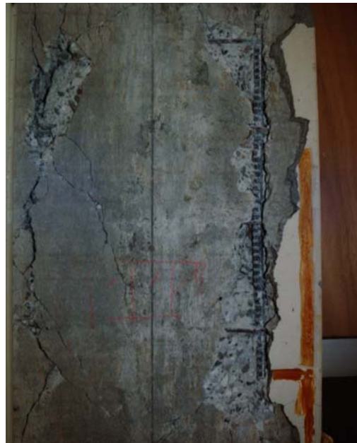
写真 2.7 : 1983 年日本海中部地震における浪岡病院では、柱の異形鉄筋の主筋に沿って付着割裂ひび割れが見られた。コンクリート強度が低く、粗骨材の品質不良。
