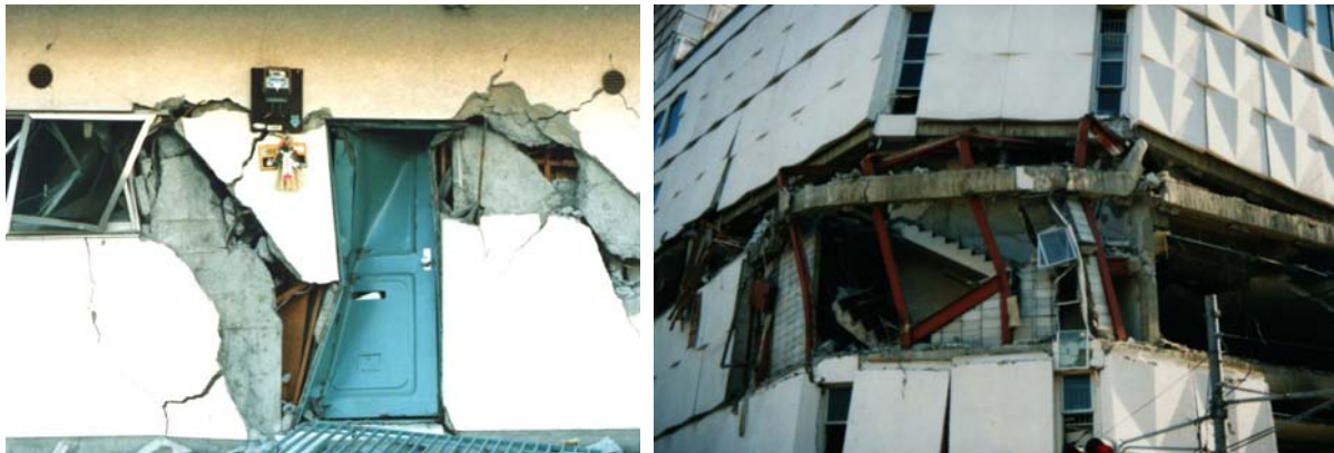
写真 1.7 : (左)入り口扉の被害とコンクリートの間仕切壁の破壊（1995 年兵庫県南部地震）。 (右)プレキャストコンクリートカーテンウォールの落下（1995 年兵庫県南部地震）。
