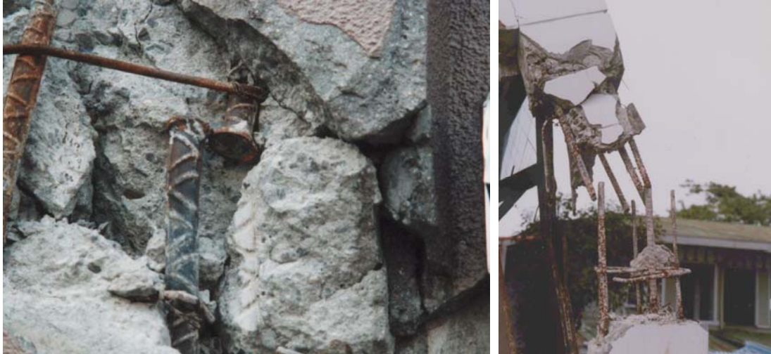
写真 2.8 : (左)1995 年兵庫県南部地震におけるガス圧接溶接継ぎ手の破断。(右)1990 年 Luzon(フィリッピン)地震における重ね継ぎ手の破壊。
