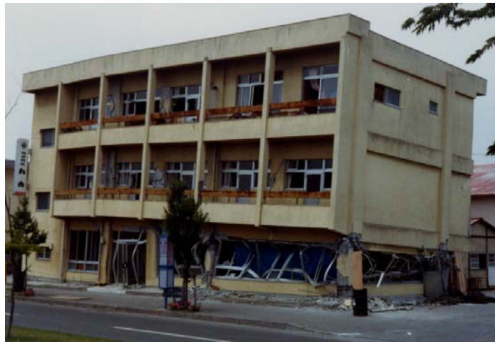
写真 1.4: 外壁が 1 階で途切れている右端で大きな被害が生じた。左側では壁が 1 階まで連続しており、剛性が高い。（1978 年宮城県沖地震）
