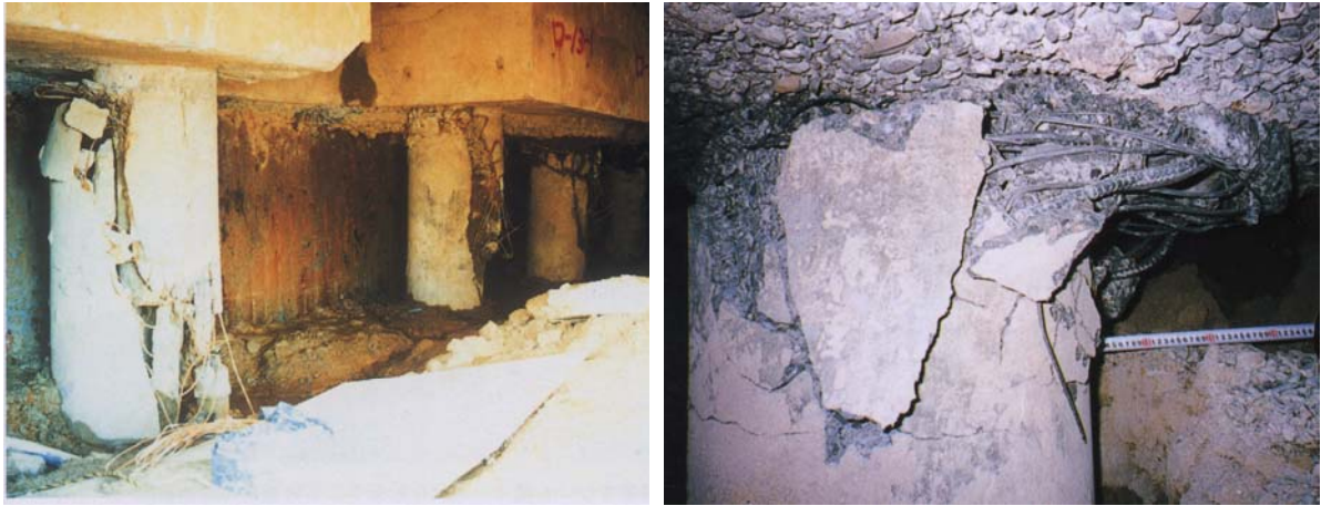
写真 2.12 : 1995 年兵庫県南部地震における被害。(左)埋立地における杭の破壊。(右)液状化に伴う側方流動による杭の破壊。
