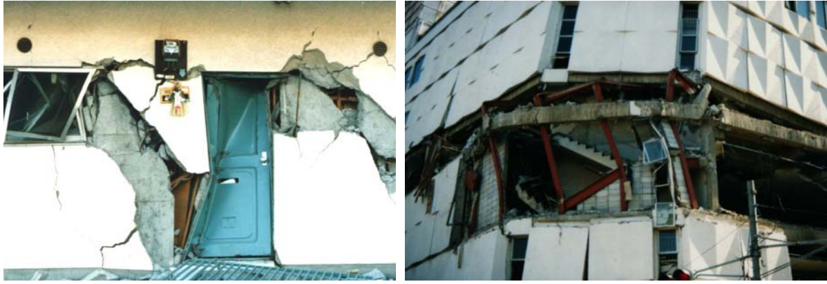
照片 1.7: (左) 屋门破坏以及房间隔断的破坏 (1995 年兵库县南部地震)。 (右) 预制混凝土窗帘壁掉落 (1995 年兵库县南部地震)。
