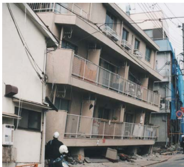
照片 1.3：1995 年兵库县南部地震中发生 1 层坍塌的六甲大厦
