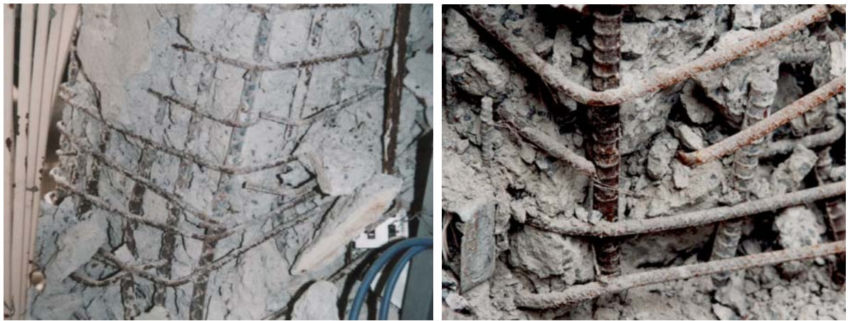
照片 2.5: 1995 年兵库县南部地震中柱的剪切破坏。(左) 90 度弯曲部分张开的例子。(右) 柱角处横加固钢筋断裂的例子。
