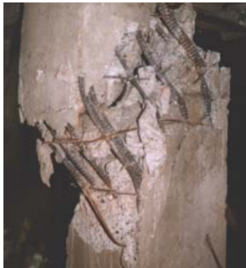
照片 2.3: 1990 年吕宋 (菲律宾) 地震中由于剪切加固钢筋过细、加固钢筋的间隔过疏引起剪切破坏的柱。
