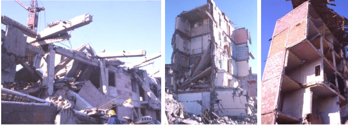
照片 2.11：1988 年亚美尼亚的斯皮塔克地震中预制混凝土的建筑物的倒塌。(左)正在建设的建筑物的坍塌。(中)现浇混凝土壁式结构的坍塌。(右) 预制混凝土和现浇混凝土砖墙建筑物的坍塌。
