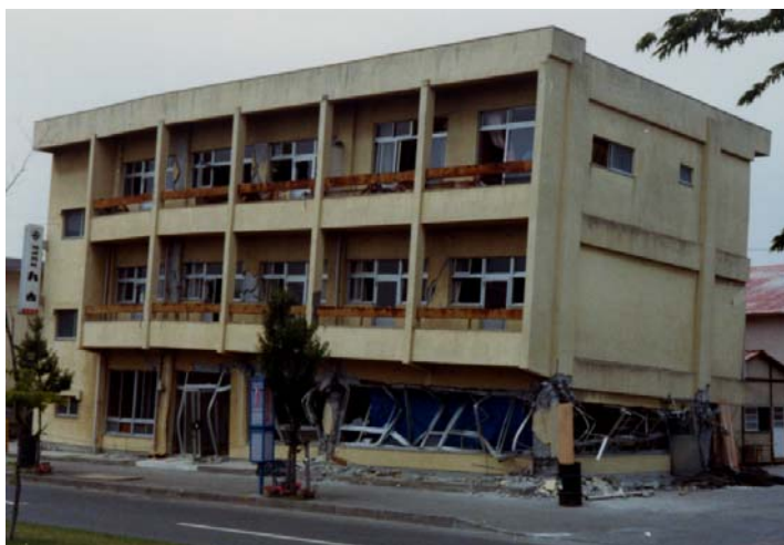
照片 1.4：外墙在 1 层中断的右侧发生巨大破坏。左侧由于墙壁从上层连到 1 层，刚度较大。 (1978 年宫城县近海地震)
