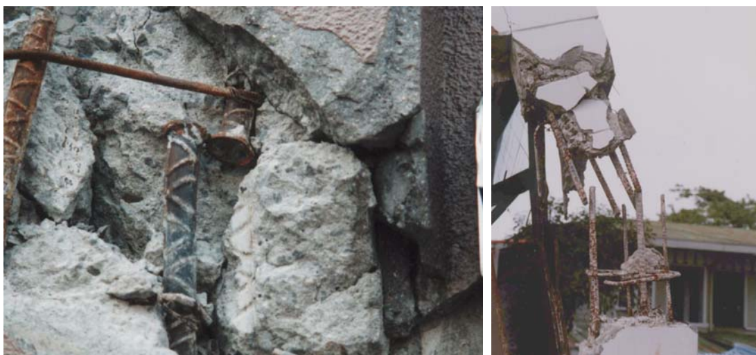
照片 2.8：（左）1995 年兵库县南部地震中煤气热压熔接接头断裂。 （右）1990 年吕宋(菲律宾)地震中的搭接接头破坏。
