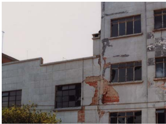
照片 1.6: 1985 年墨西哥地震中毗邻的建筑物发生碰撞。
