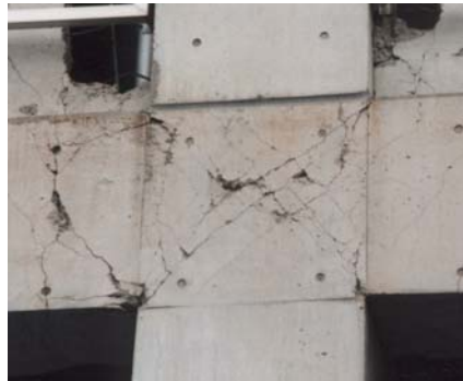
照片 2.10：1995 年兵库县南部地震中梁弯曲屈服先行型框架的柱梁连接处的剪切裂缝。
