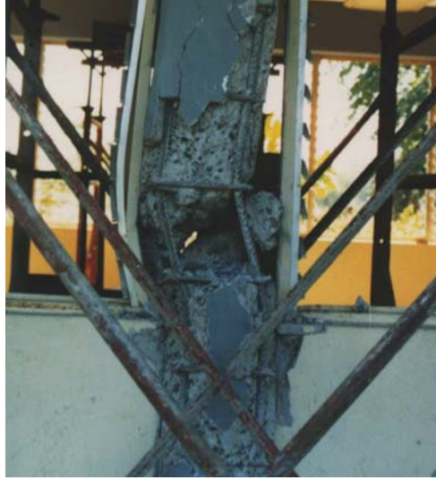
照片 2.4: 柱的剪切破坏。1995 年墨西哥地震中拉萨罗卡德纳斯 (Lazaro Cardenas) 的学校建筑。粗径横加固钢筋的间隔如同柱的宽幅。沿柱主钢筋的混凝土剥落。
