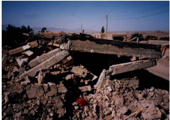
照片 2.2: 1997 年 Qayen (伊朗) 地震中因大的水平变形而倒塌的框架。柱主钢筋从柱梁连接处脱离发生破坏。
