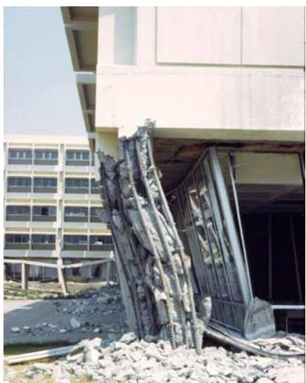
照片 1.2：1971 年圣. 费尔南多（加利福尼亚）地震中受破坏的 Olive View 医院
